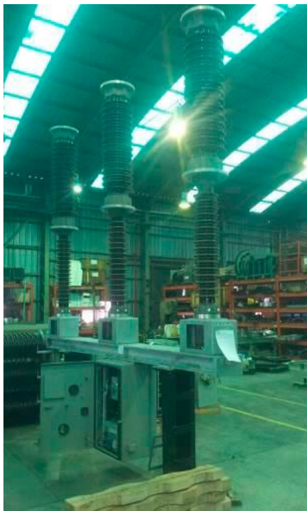
Vista General del seccionador
