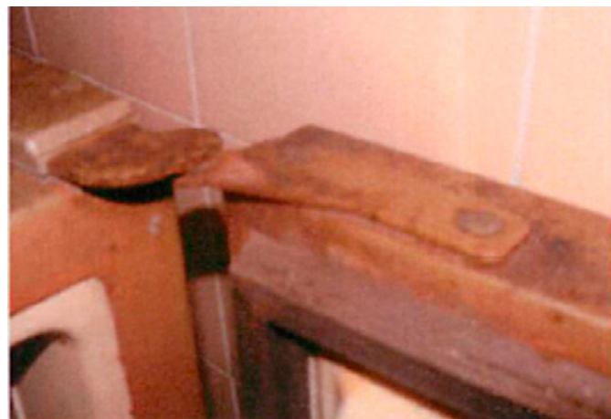
PORTA: Pino e dobradiça em péssimo estado.
