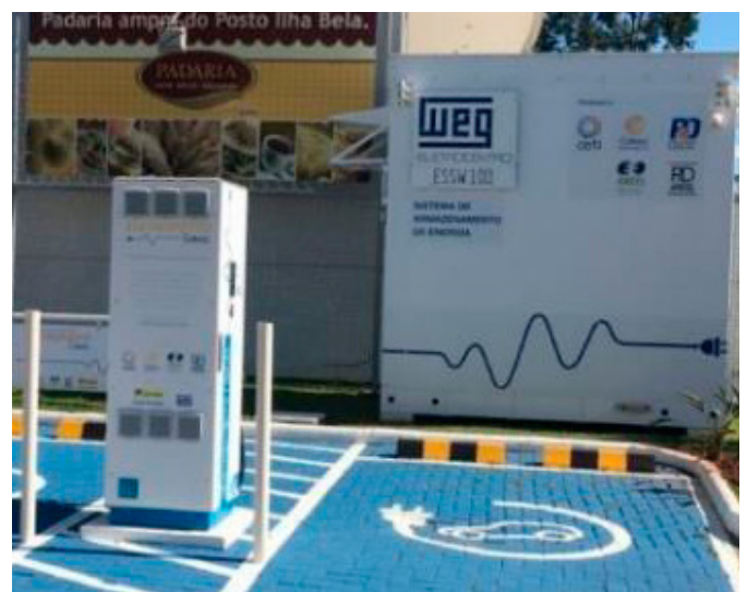
Figura 8. Estação de recarga rápida e sistema de armazenamento instalados em Florianópolis na composição do Eletroposto Modelo.
