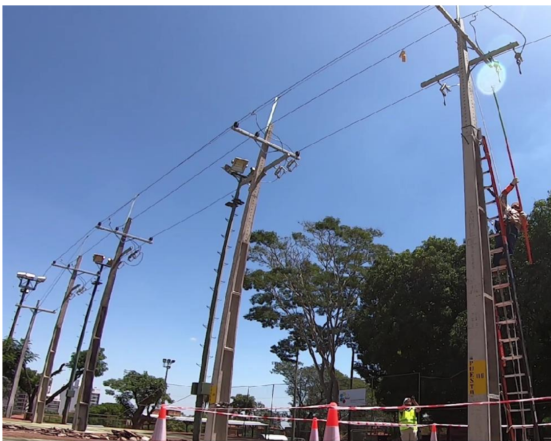
Vista de parte de la Línea de 33 kV
